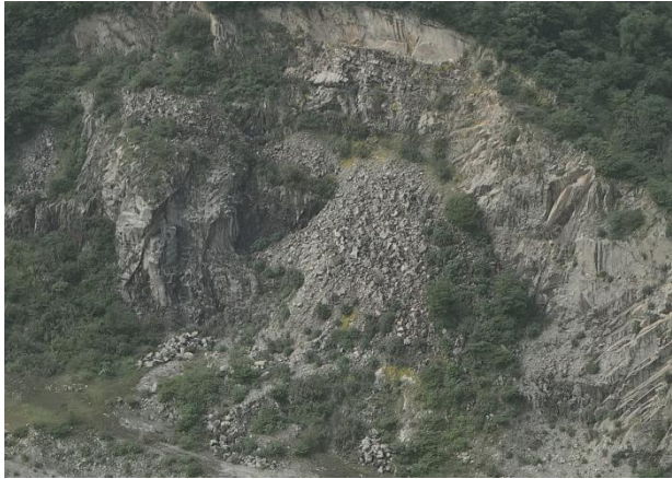
照片 4-5 崩塌部位 2
