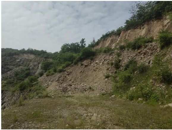
照片 4-4 崩塌部位 1
