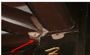
榫卯节点破损
